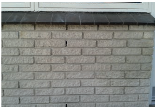
Murbrytning med revner og nedbrudte fuger ved vinduer
