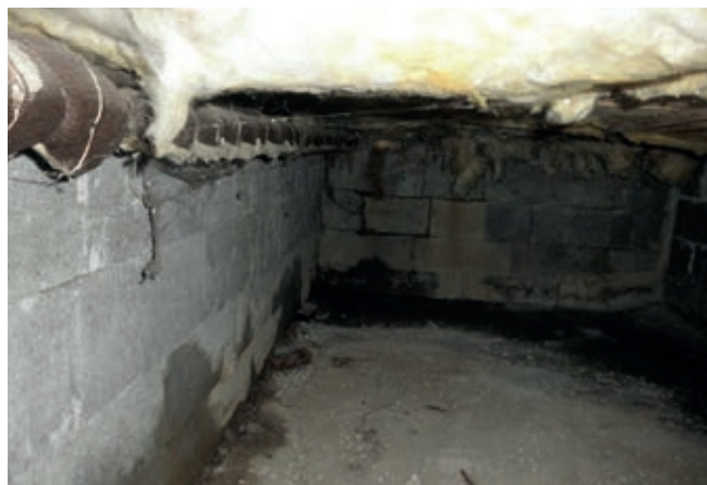
Krybekælder med hængende isolering og fugt
